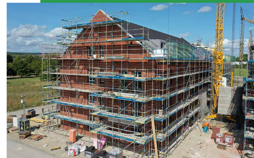
Fenster und Außenhülle (hier von Haus A2) sind bereits fertiggestellt und der Innenausbau läuft.
